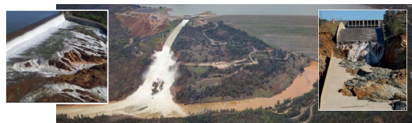
図-2 長期供用中ダムの洪水放流で損傷した洪水吐きが使用不能となったことに伴う堤体外からの越流事故（米国、2017）
