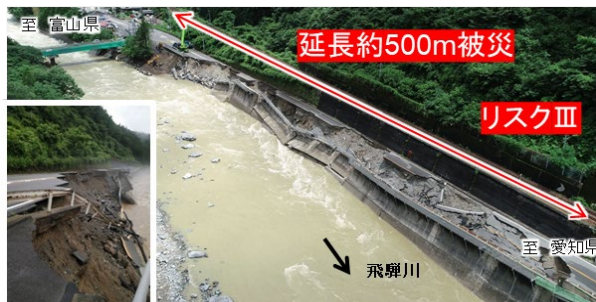
図-1 国道41号における洗掘被災の様子
