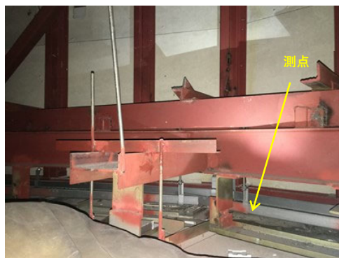
図-2 大判ガラス上部の状況
