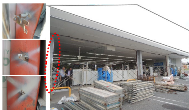
図-1 令和元年房総半島台風でサッシが転倒した被害 (左の3枚の写真は、右写真赤円内の接合箇所) *1
