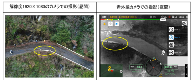
図-5 ガードレールの損傷 (ホバリング撮影)
