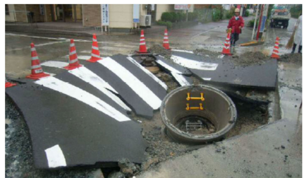
図-1 舗装破壊を伴うマンホールの被災事例
