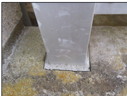
写真Ⅲ.4.4 アルミニウム製手すり支柱付け根のシーリング材の被着体からの剥がれ
