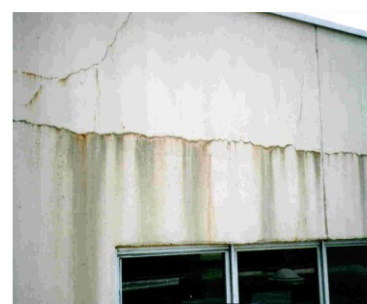
写真6 外壁上部の屋根防水周辺部のひび割れ(横方向)
