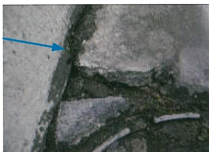
写真4 押え層コンクリートの欠損
