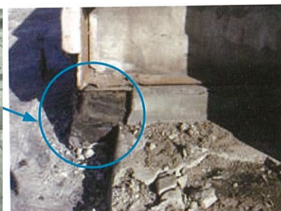
写真2 防水層の露出
