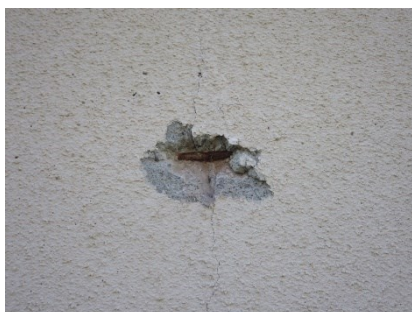
外壁面（鉄筋の爆裂）
