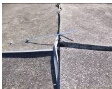
写真5 目地部分のせり上がり
