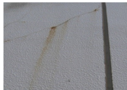
写真3 ひび割れからの錆汚れ
