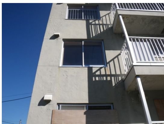
南面（ふくれの発生）
