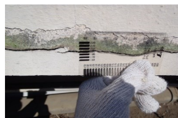
ベランダ鼻先 (ひび割れ)
