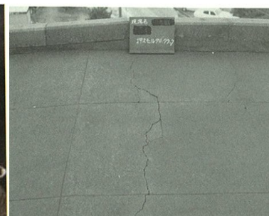
写真3 押え層コンクリートのひび割れ
