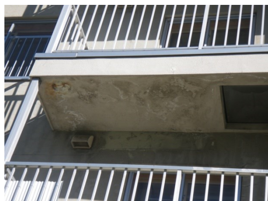
南ベランダ見上げ（ふくれ、浮き）
