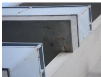
階段室見上げ (はがれ)
