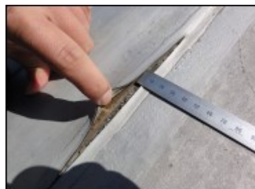
補修部の亀裂
