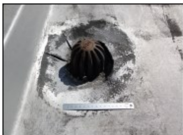
ドレン周りのはく離、口開き
