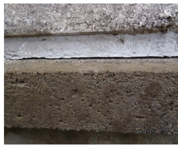
シーリング材 (被着体からの剥離)
