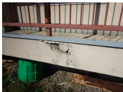
ベランダ鼻先（ひび割れ、鉄筋の爆裂）
