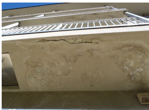
南側ベランダ見上げ（はがれ、浮き）
