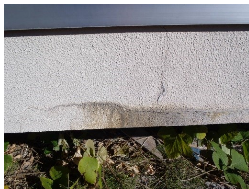
ベランダ鼻先部分（ひび割れ）
