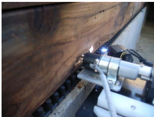
写真 5.9.4(診断対象の例1:土台劣化部)
