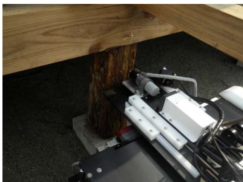
写真 5.9.6(診断対象の例1:床束劣化部)
