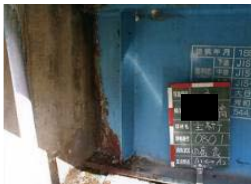
図 1-3-6 鋼主桁ウェブ端部の腐食
