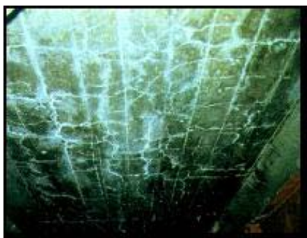
図1-0-1 コンクリート床版の疲労損傷
