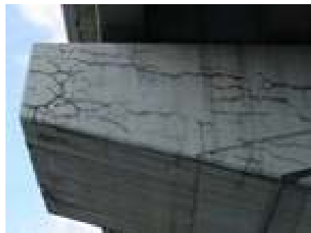
図1-0-4 アルカリ骨材反応を生じた橋脚
