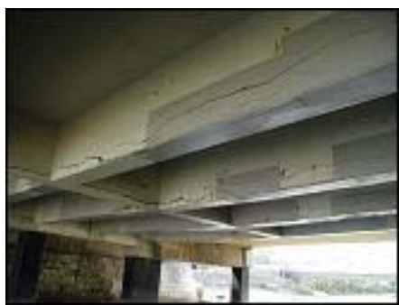
図1-0-3 塩害を受けたコンクリート橋
