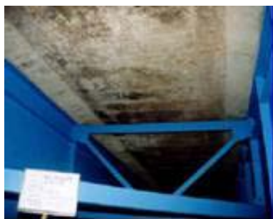
(a)RC床版のひび割れ
