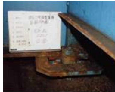
(b)桁端部の腐食
