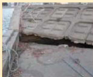
クラックが生じた河川護岸
