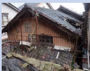
保安上危険な状態の空家の例
