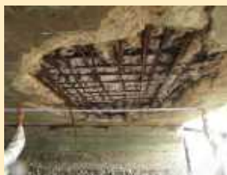
内部の鉄筋が露出した橋梁
