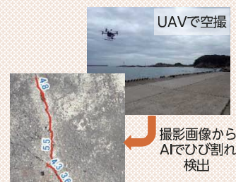
ひび割れの検出例
