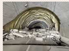
能登半島地震でのトンネル覆工崩落の例
