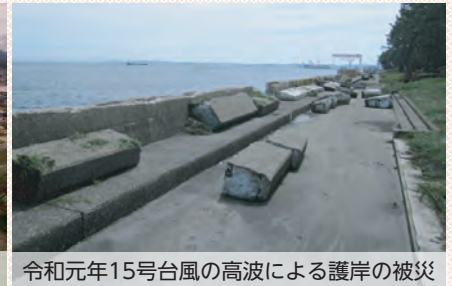
令和元年15号台風の高波による護岸の被災
