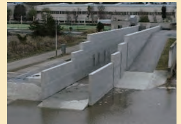
「粘り強い河川堤防」整備の検討に必要な越水実験等が可能な実験水路を整備
