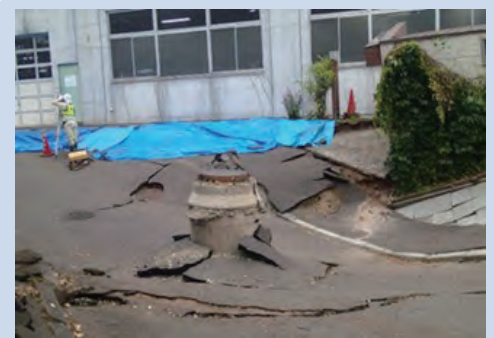
液状化によるマンホールの浮上 (被災箇所の管路属性を整理)
