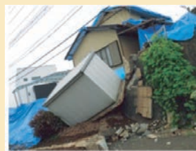
被災した宅地と住宅
