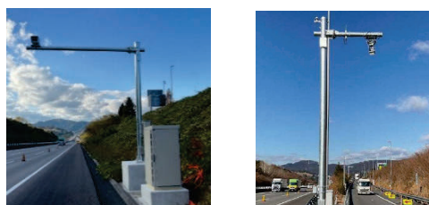
図-3 合流支援情報提供システムの機器 （左：車両検知センサ、右：情報提供施設）
