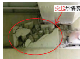
(b) 突起が損傷した事例
