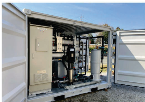
写真-2 可搬型コンテナ式浄水処理ユニット
