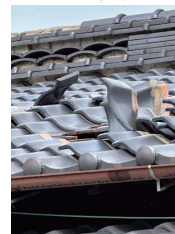
屋根瓦の脱落(つくば市)
