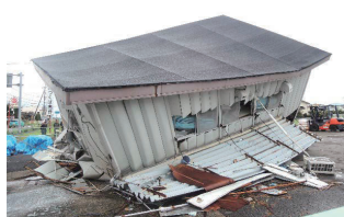
鉄骨造建築物の倒壊(つくば市)
