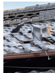
屋根瓦の脱落(つくば市)
