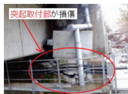
(a) 突起取付部が損傷した事例
