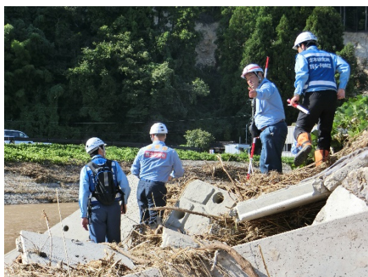
写真-1 河川管理施設等の被害状況調査の様子 (令和 6 年 9 月 20 日からの大雨)
