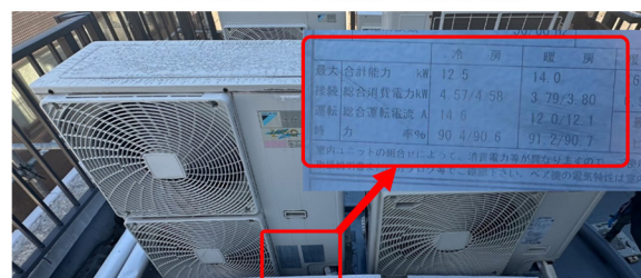
b) 屋上に空調熱源(室外機)の能力を確認
