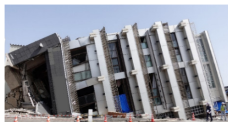
鉄筋コンクリート造建築物の転倒被害
