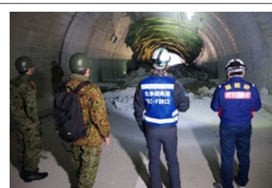
写真-2 覆工が大規模に崩落したトンネルの調査
