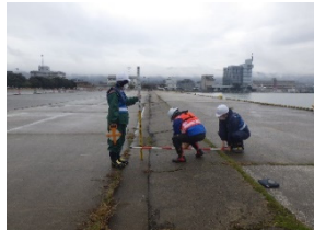
七尾港矢田新栈橋(第一西)の被災状況
