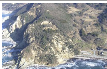
写真-1 大規模斜面崩壊個所の上空からの調査
