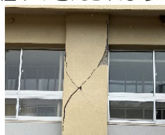
柱のせん断破壊
