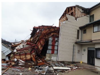
鉄骨造建築物の2階と3階が倒壊
