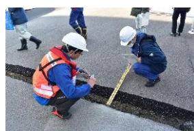
TEC-FORCEによる金沢港御供田1, 2号岸壁の被災状況調査
