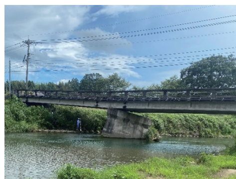
写真-1 洗掘により被災した橋脚
