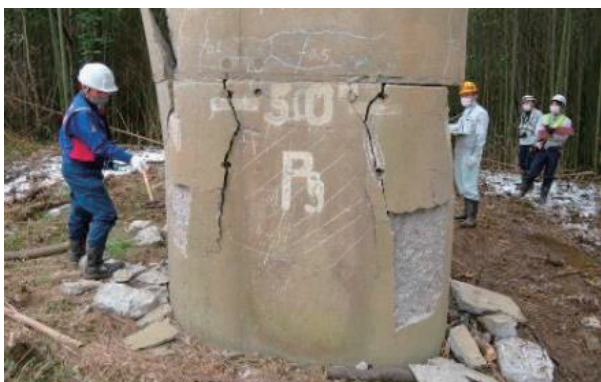
写真-1 地震で被災した角田市の枝野橋
