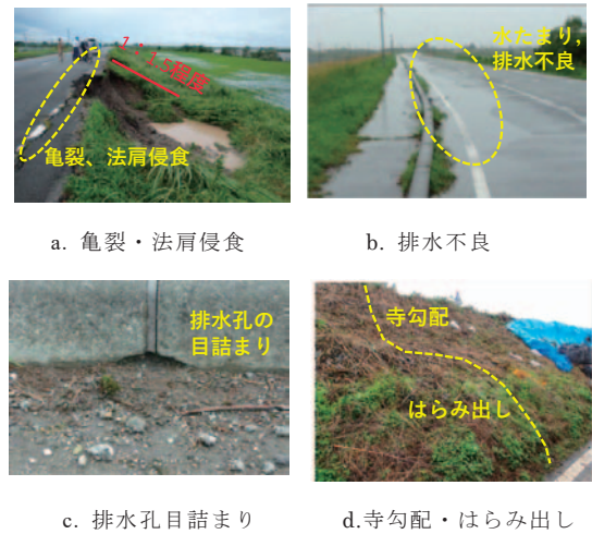
図-2 被災箇所周辺で確認された変状
