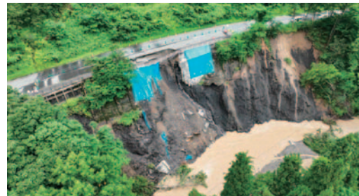
図-1 令和4年8月豪雨での国道121号の被害 (山形県米沢市)
