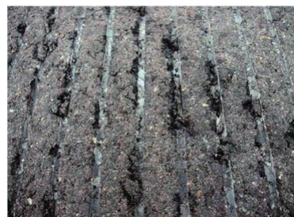
写真2 破損したグルーピングの例
