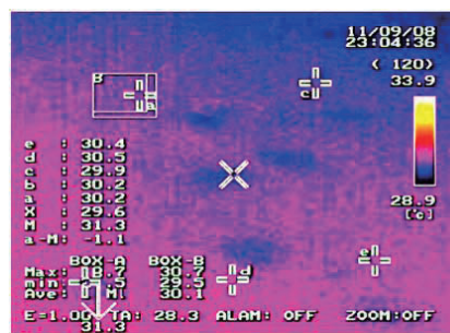
写真1 熱赤外線画像(中央の青色の円が剥離部)
