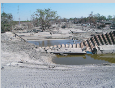
写真-1 破堤箇所周辺
