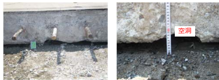
被災した仙台空港のエプロン下の空洞
