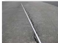
岸壁背後のクラック (八代港)
