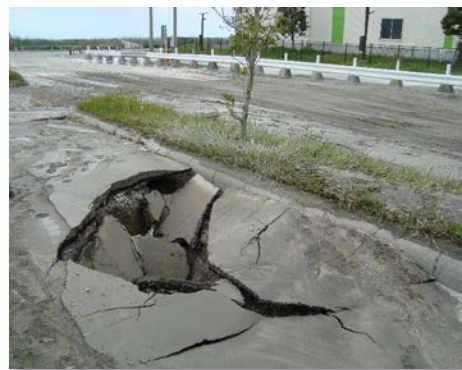
液状化による噴砂・陥没 (熊本港・人工島内)
