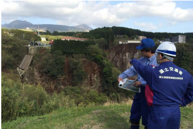
阿蘇大橋落橋現場における被害状況調査 (橋梁研究室長)
