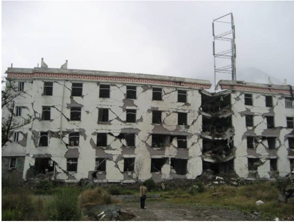
写真1 1階が完全に崩壊した5階建ての学生寮（映秀）
