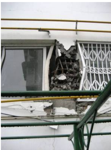
写真5 短柱のせん断破壊 (都江堰)
