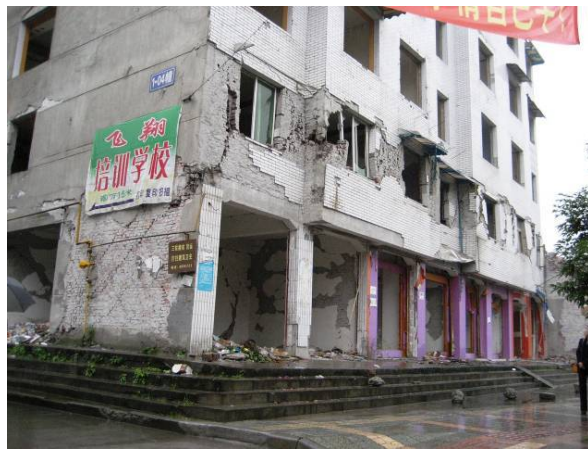
写真4 2階に被害が集中した建築物（都江堰）
