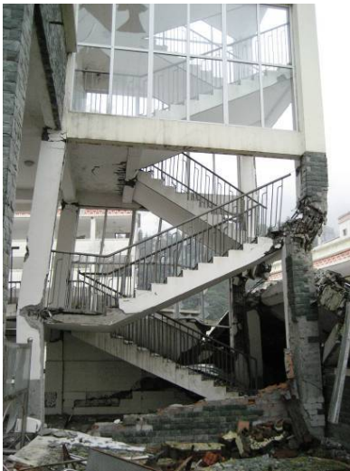
写真7 階段が取り付く柱の破壊 (映秀)
