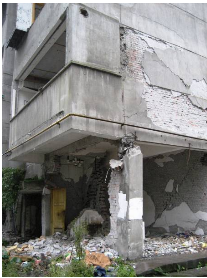
写真3 下階壁抜け部分で大きく損傷した1階の柱（都江堰）
