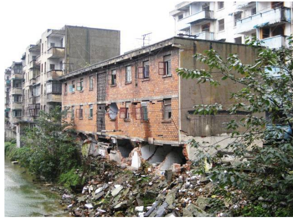
写真2 1階が大きく破壊された組積造（漢旺）
