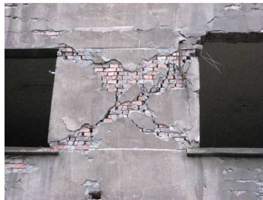
写真8 組積造による非構造壁のせん断破壊 (都江堰)
