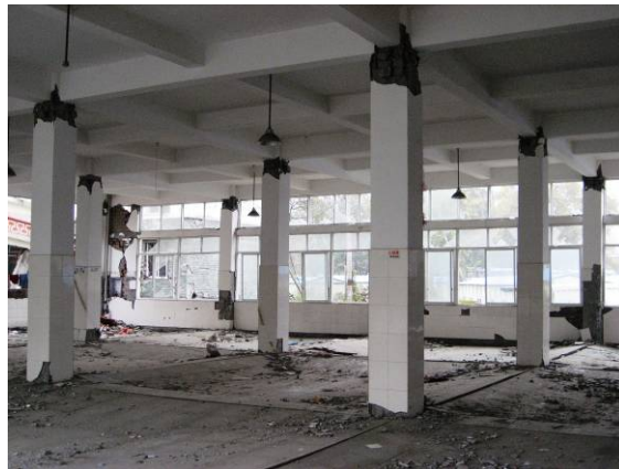
写真6 柱頭・柱脚の曲げ破壊 (映秀)
