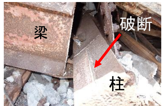
R8熊本地震で被害を受けた鉄骨柱梁接合部の破断事例
