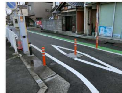
設置されたライジングボラード
