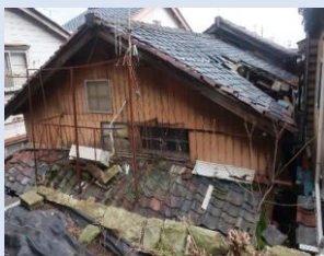
保安上危険な状態の空家の例
