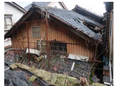
保安上危険な状態の空家の例
