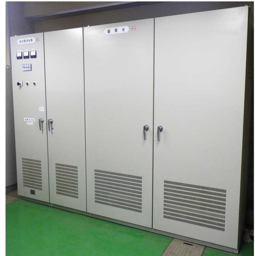
直流電源設備の例
