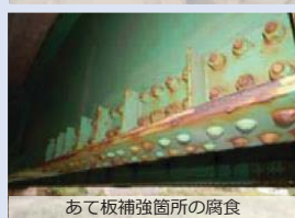
あて板補強箇所の腐食
