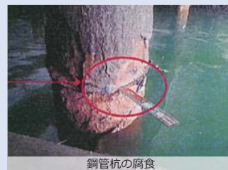
鋼管杭の腐食
