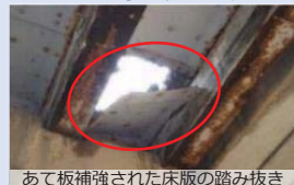
あて板補強された床版の踏み抜き
