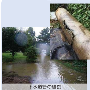
下水道管の破裂
