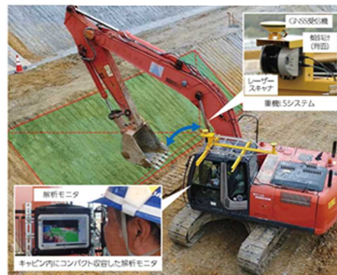
○建設機械搭載事例
