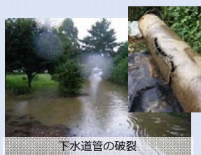
下水道管の破裂
