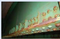
あて板補強箇所の腐食
