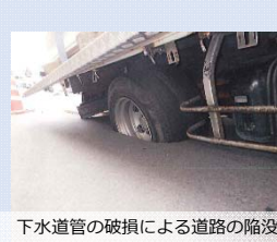
下水道管の破損による道路の陥没
