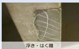
浮き・はく離
