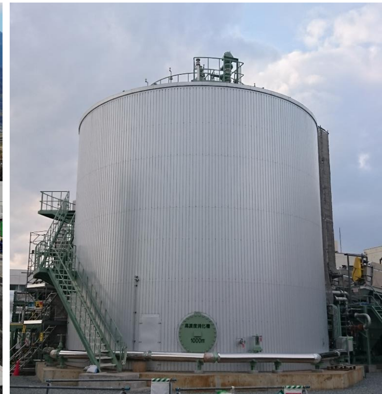
高濃度消化槽(有効容積1,000m 3 )
