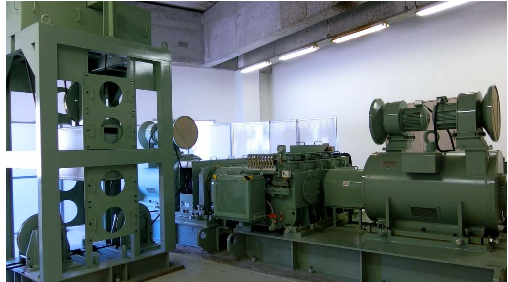
②機械室(ウィンチ装置作動)
