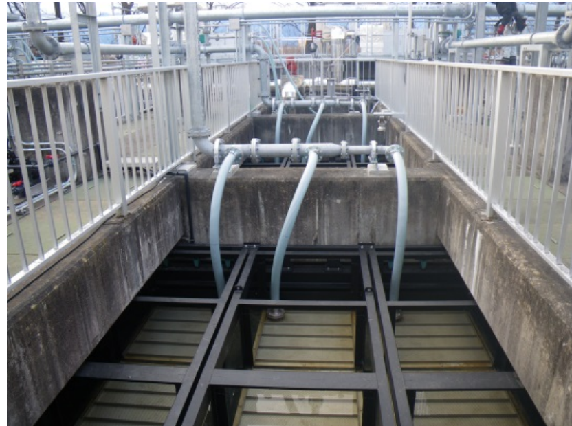
実証施設(ろ過部)
