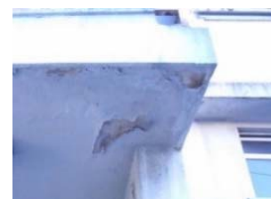
外装材のはがれ
