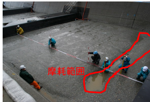
写真1（全景）水路の床の摩耗状況
