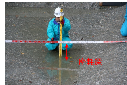
写真2（近景）床版の摩耗状況
