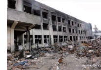
地震誘発火災被害例
