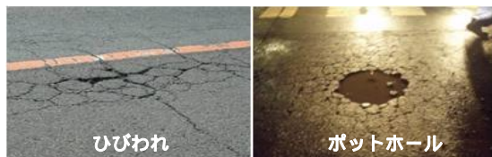
【空港舗装の損傷事例】
