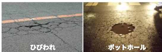
【空港舗装の損傷事例】
