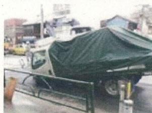
埋設管破損による道路陥没
