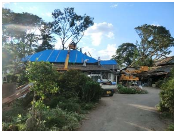
写真 5. 1. 2 屋根ふき材の被害
