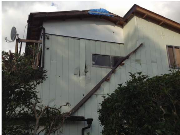
写真 5. 1. 9 外装材の被害
