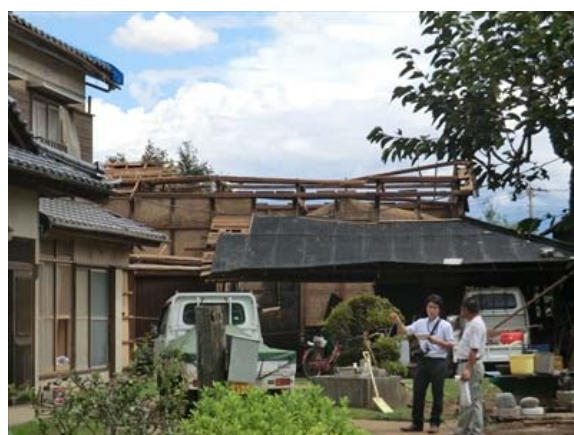
写真 5. 2. 4 小屋組の被害
