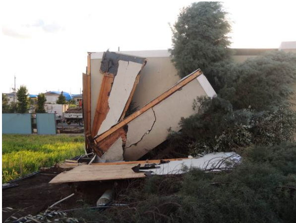
写真 4. 4. 5 木製塀の倒壊
