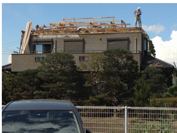
写真 5. 2. 5 小屋組の被害
