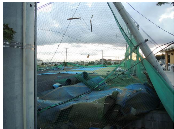
写真 4. 4. 6 テニスコート人工芝等の被害
