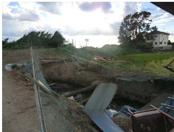
写真 5. 1. 16 フェンスの被害
