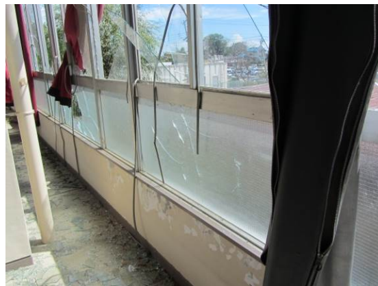
写真 4. 1. 8 ガラス窓の破損
