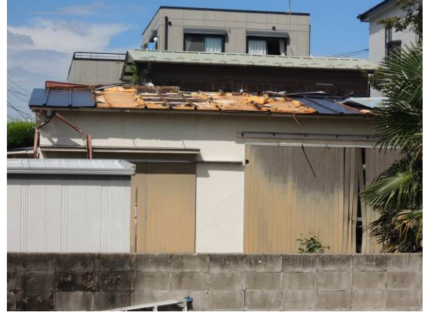
写真 4.2.10 屋根鋼板の飛散状況
