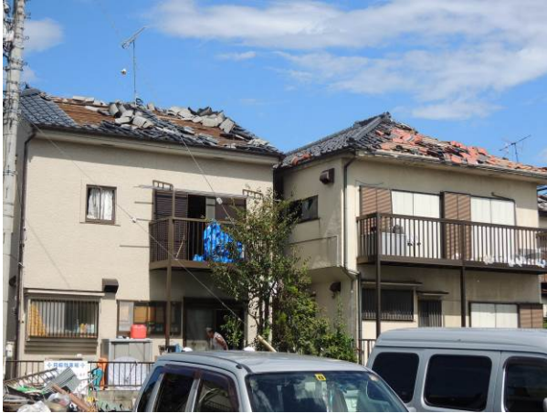
写真 4.2.9 粘土瓦の脱落状況
