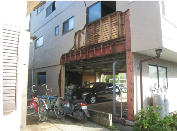
写真5 1階の開口部および壁の破壊
