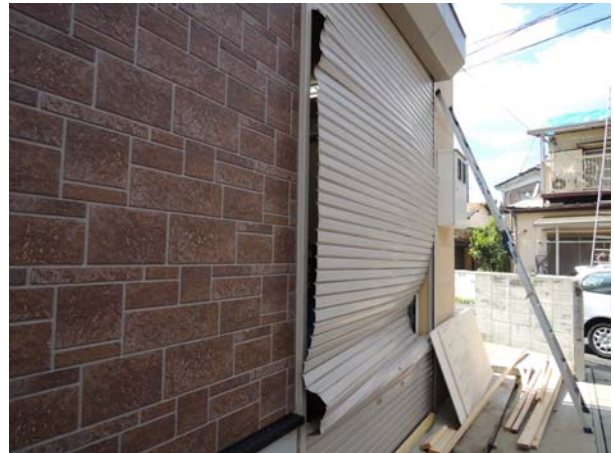
写真 4.2.12 シャッターの被害
