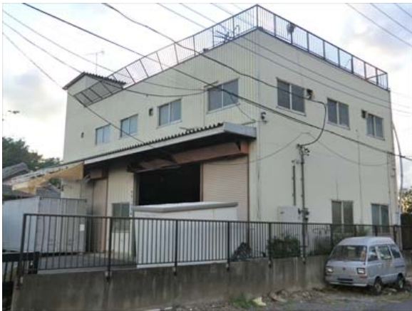
写真 5. 1. 14 屋上フェンスの被害
