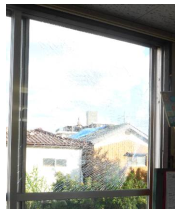
写真 4. 1. 20 合わせガラスの放射状のひび割れ
