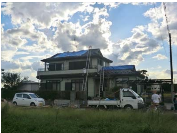
写真 5. 1. 1 屋根ふき材の被害
