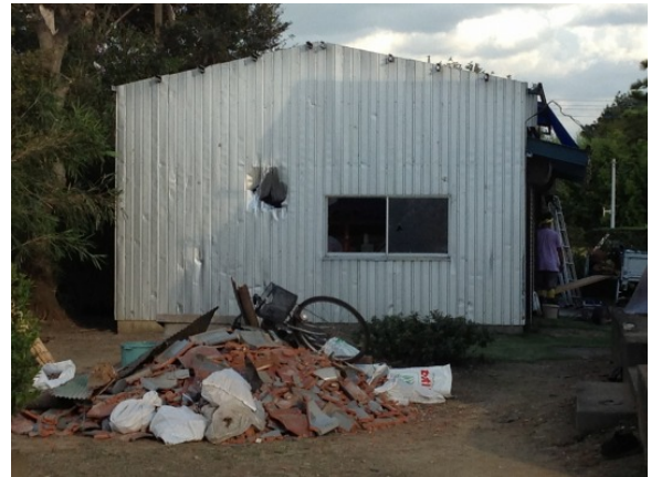
写真 5. 1. 10 外装材の被害
