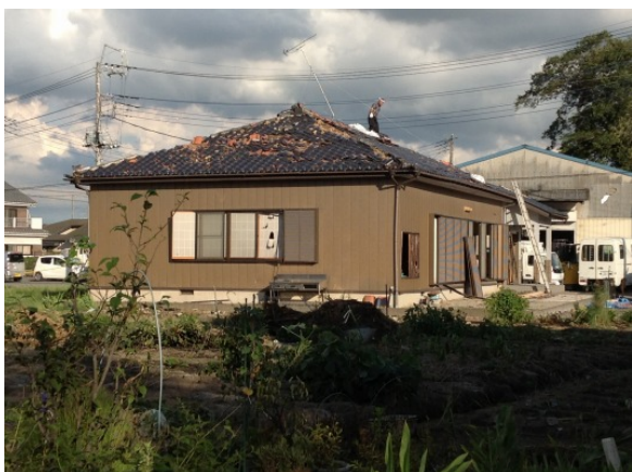
写真 5. 1. 3 屋根ふき材の被害
