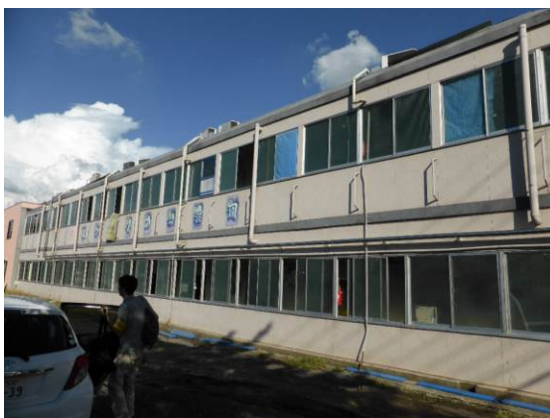
写真 4. 1. 19 建築物外観及び網入りガラス損傷
