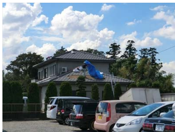
写真 5. 2. 2 屋根ふき材の被害
