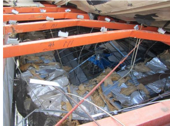
写真 4. 1. 26 母屋及び天井の破壊
