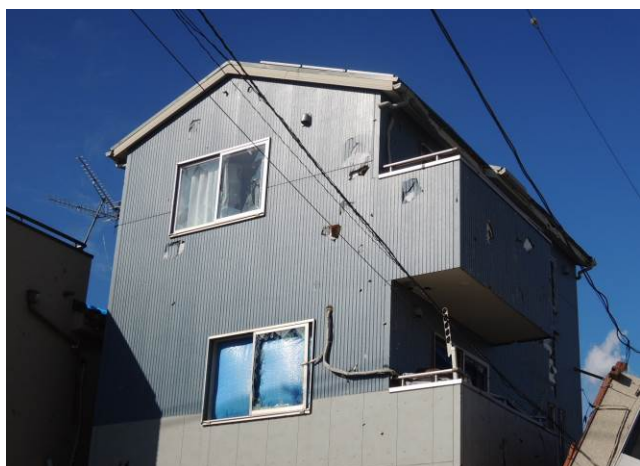
写真 4.3.1 外壁の飛来物による衝突痕
