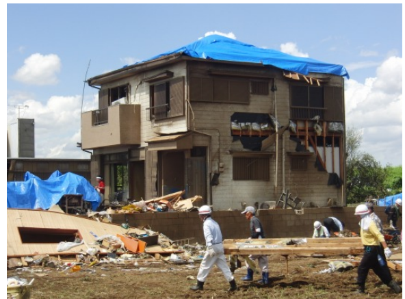
写真 5. 2. 11 外装材の破損
