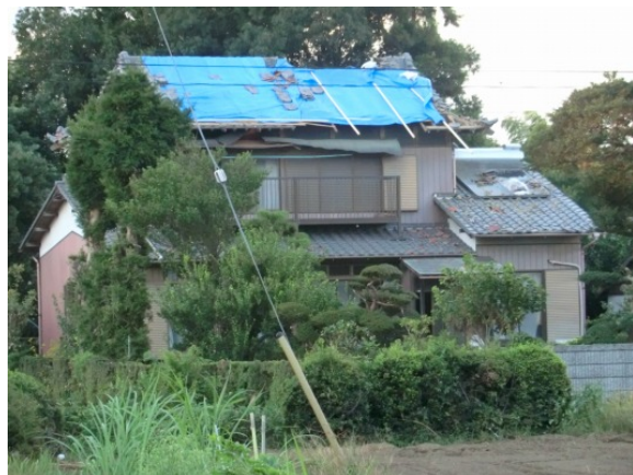
写真 5. 1. 6 屋根ふき材の被害
