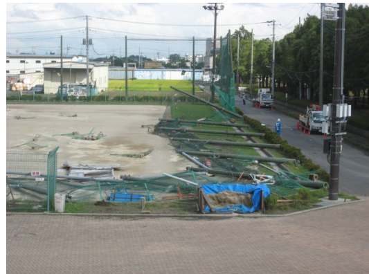
写真7 ネット支持柱の被害
