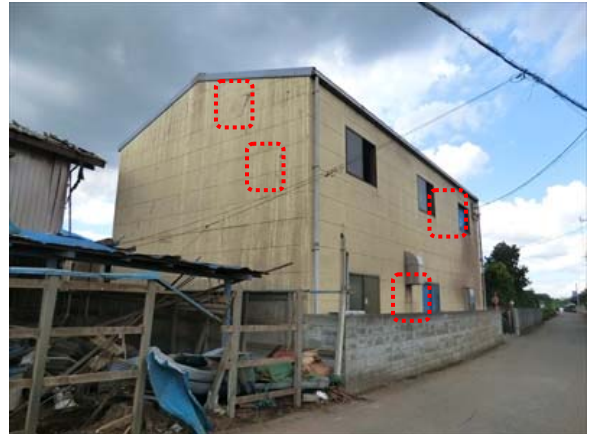
写真 5. 2. 9 外壁材及びガラスの破損
