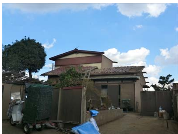
写真 5. 2. 3 小屋組の被害
