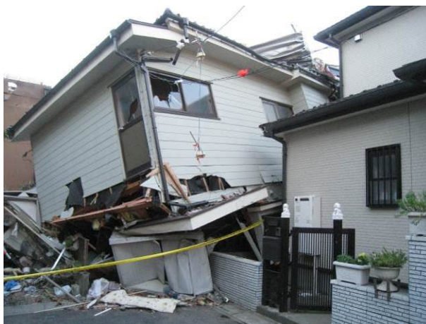
写真 4.2.2 上部構造の倒壊（2）
