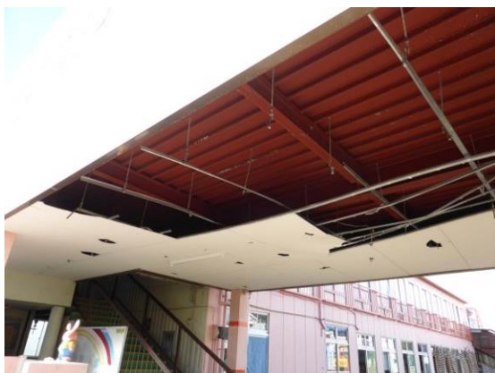
写真 4.1.21 ピロティの天井の被害
