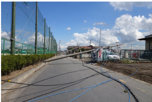
写真6 電柱の被害（室井公美子氏提供）
