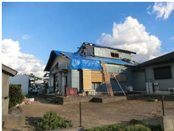
写真 5. 1. 4 屋根ふき材の被害
