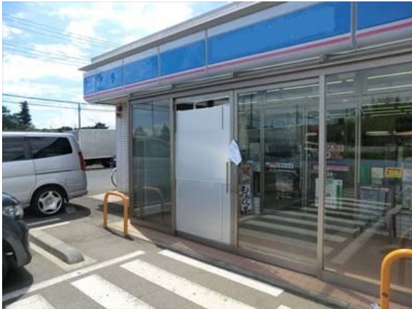
写真 5. 2. 8 ガラスの破損
