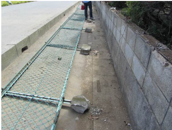
写真 4. 1. 9 フェンスの倒壊
