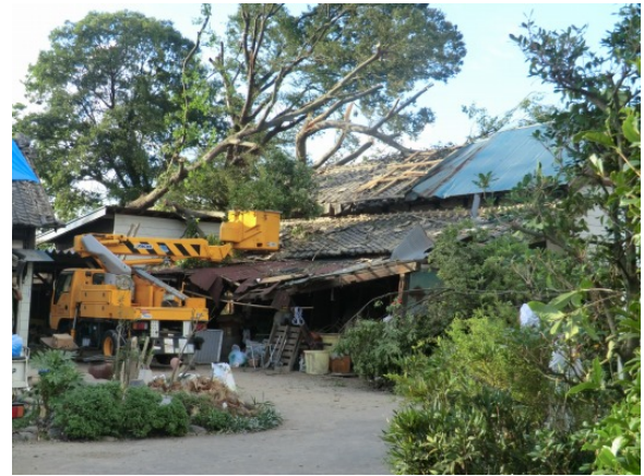
写真 5. 1. 13 樹木の倒壊による小屋組の被害
