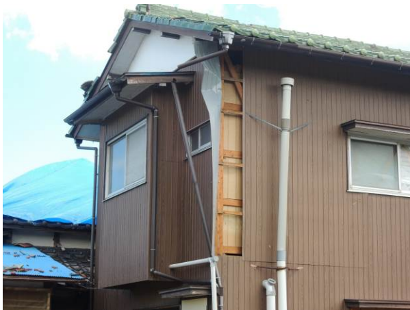
写真 4.2.11 外壁材の剥離
