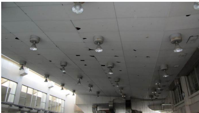
写真 4. 1. 29 天井の部分的な損傷
