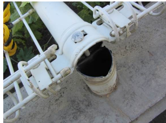
写真 4. 1. 15 支柱部の破断
