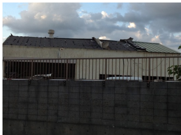
写真 5. 1. 5 屋根ふき材の被害
