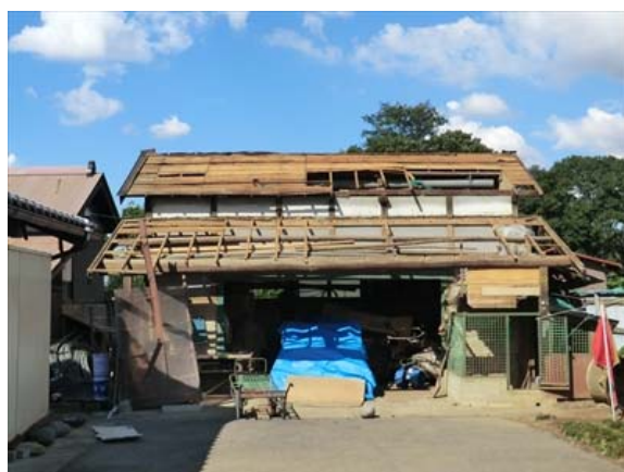
写真 5. 2. 6 小屋組の被害
