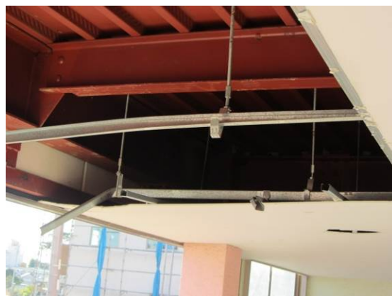
写真 4.1.22 天井の下地材の変形
