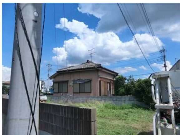
写真 5. 2. 1 屋根ふき材の被害
