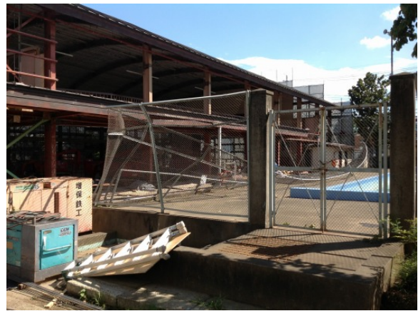
写真 5.2.19 フェンスの被害 (工事中の建築物)
