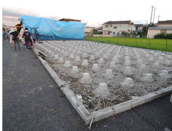
写真 4.2.4 飛散した上部構造の基礎
