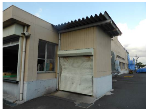
写真 4. 1. 30 シャッターの変形
