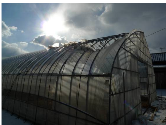
写真 18 パイプハウスの被害
