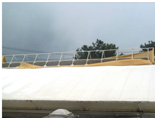
写真8 屋内プール施設の膜材の破れ
