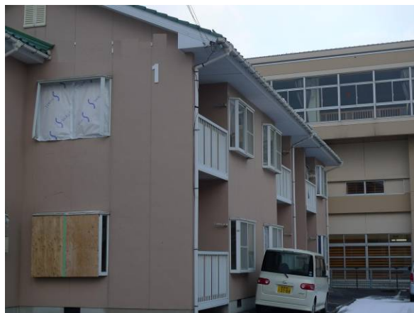
写真 13 隣接するアパートの開口部被害
