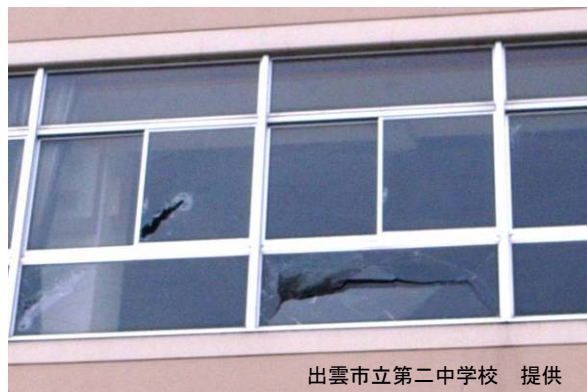
写真3 体育館窓ガラスの破損
