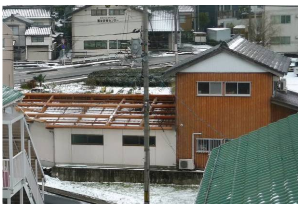
写真 10 屋根の被害状況の概観
