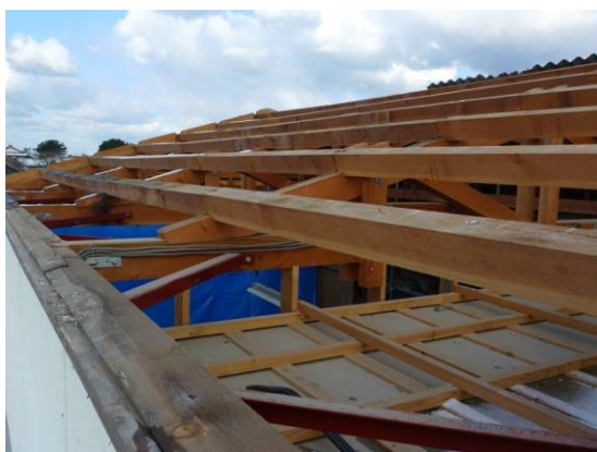
写真 14 屋根の被害状況
