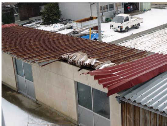
写真7 倉庫の折板屋根の損傷
