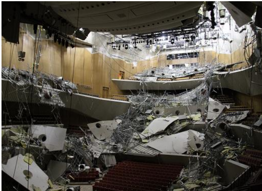
音楽ホールにおける天井の脱落
