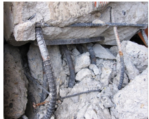
写真 18 SRC 柱脚部の損傷
