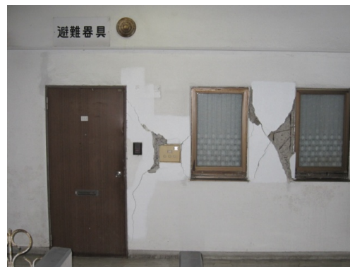
写真 81 非構造壁のせん断ひび割れ
