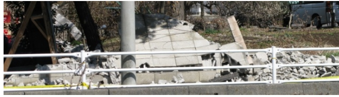
写真 24 ブロック塀の倒壊
