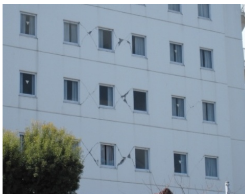
写真 40 非構造壁のせん断ひび割れ
