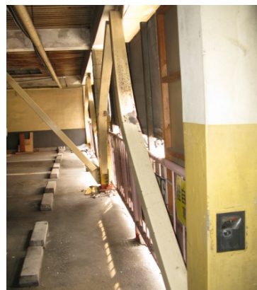
写真 65 鉄骨造ブレースの座屈
