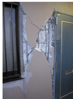
写真 89 非構造壁のせん断破壊
