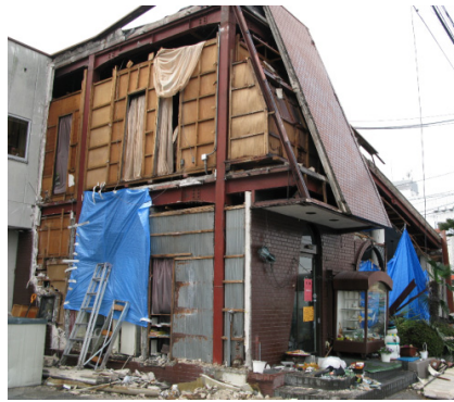
写真 129 外装材の被害 6
