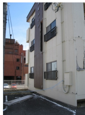
写真 23 ALC パネルの落下
