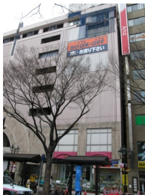
写真 67 外装材の脱落
