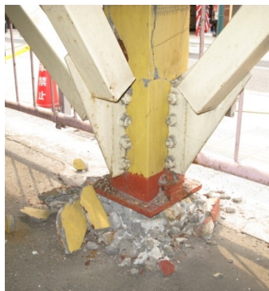
写真 64 鉄骨造柱脚部の損傷
