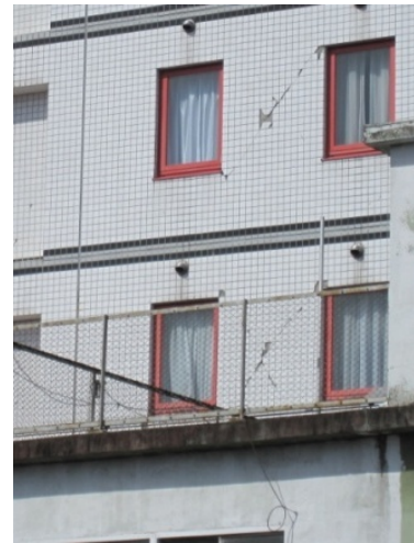
写真 43 非構造壁のせん断 ひび割れ
