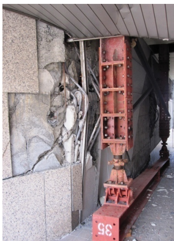
写真 46 1階柱のせん断破壊
