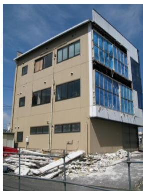
写真 22 ALC パネルの落下
