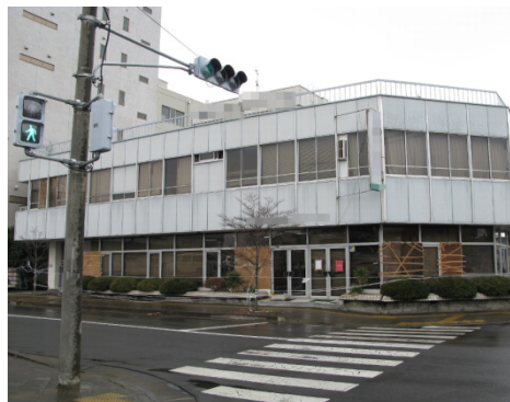
写真 134 窓ガラスの破損
