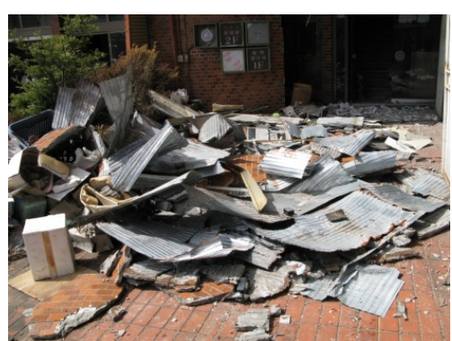
写真 21 落下した外壁の仕上げ
