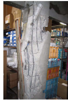
写真 107 長柱のせん断破壊
