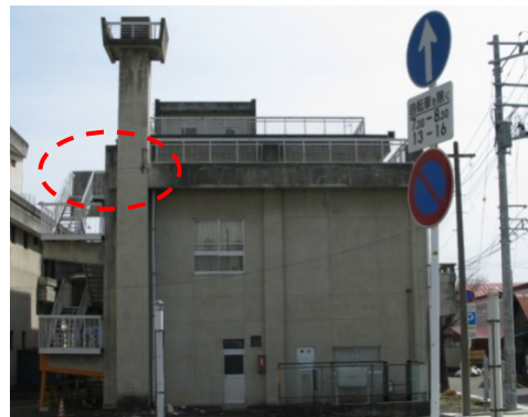
写真2 煙突の曲げひび割れ
