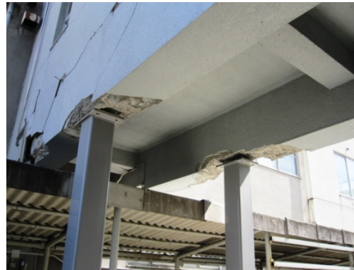
写真 32 渡り廊下の損傷
