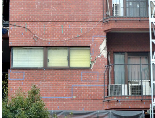
写真 79 短スパンの間柱のせん断破壊
