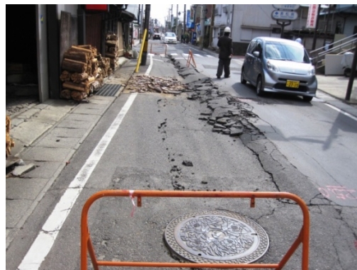
写真 62 道路の地盤変状
