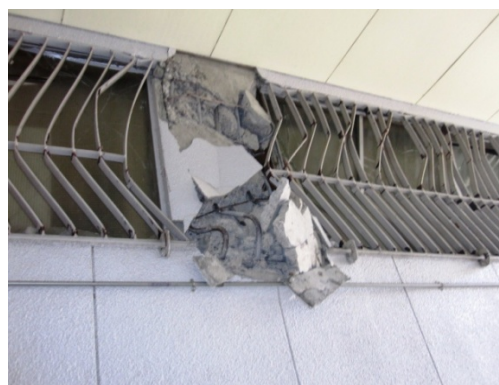
写真 48 2階の短柱のせん断破壊
