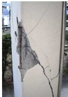
写真 97 1F 柱のせん断破壊
