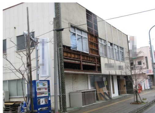
写真 127 外装材の被害 4
