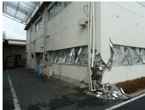
写真101 腰壁付き短柱の軸崩壊
