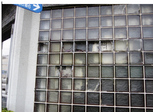
写真 133 ガラスブロックの破損
