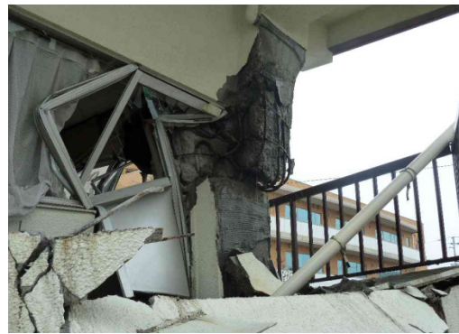
写真 109 腰壁付き短柱の軸崩壊
