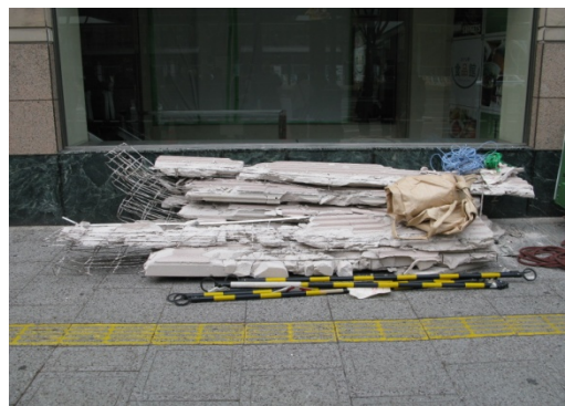
写真 68 落下した ALC パネル
