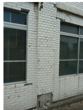
写真 36 柱脚部の損傷
