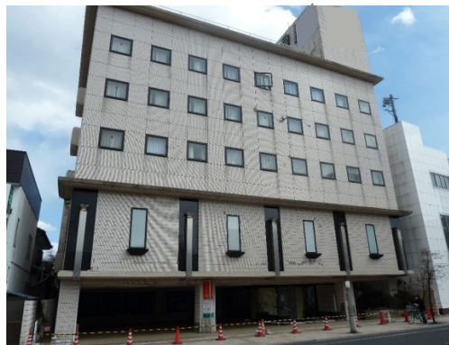
写真 44 外壁の損傷、タイルの落下
