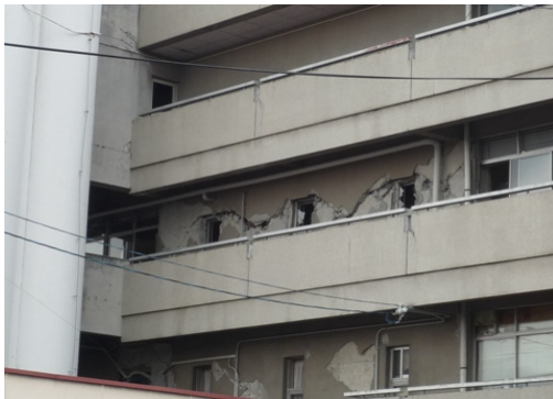
写真 31 非構造壁の損傷
