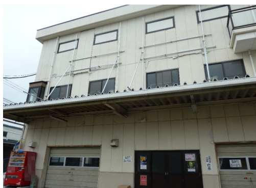
写真 105 外装材（ALC パネル）の損傷
