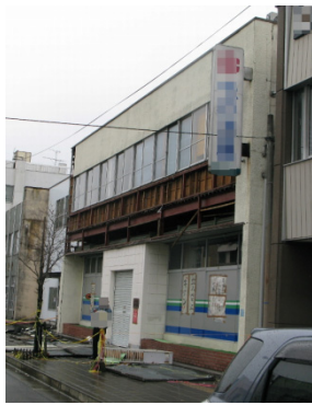
写真 128 外装材の被害 5
