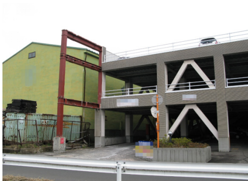
写真 124 外装材の被害 1
