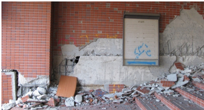
写真 17 壁及び SRC 柱脚の損傷
