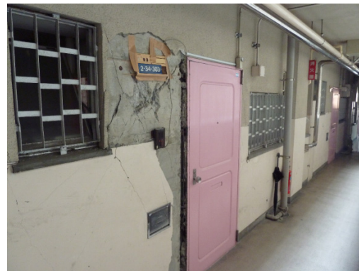
写真 77 非構造壁のせん断破壊
