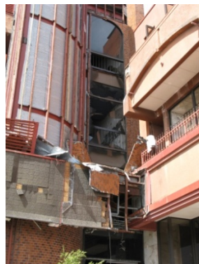
写真 20 外壁仕上りの落下
