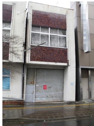
写真 131 建物の残留変形が生じた建築物
