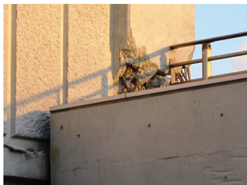
写真 91 高層棟 3F 側柱脚部の圧壊
