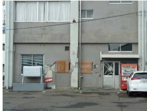
写真99 腰壁付き短柱のせん断破壊
