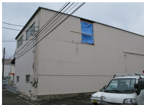
写真 126 外装材の被害 3
