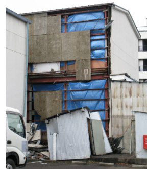
写真 125 外装材の被害 2
