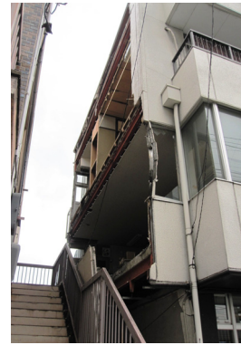
写真 130 外装材の被害 7
